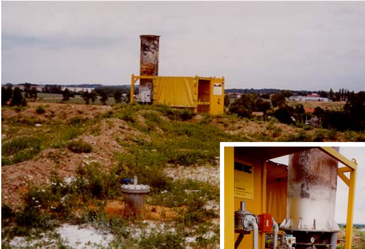
Absaug- und Fackelstation mit Gasbrunnen und Erdämmen für Brunnensaugleitungen
