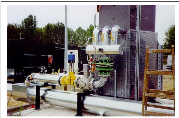
Fackel und Verdichterstation
