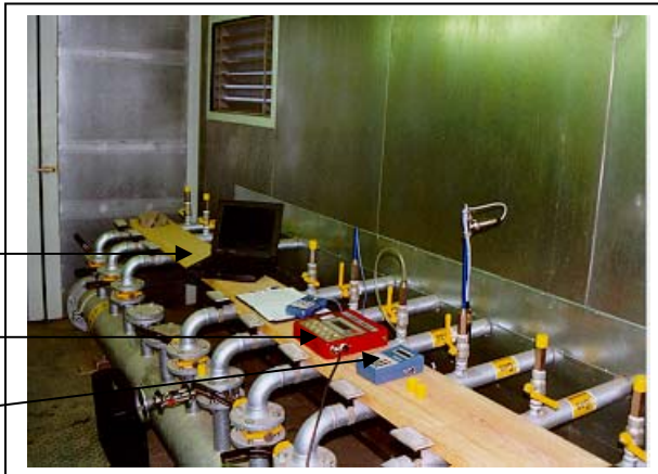
Einsatz Messgeräte zur Gasbrunneneinregulierung
