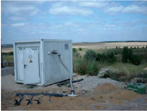
Absauganlage, Gassammelbalken und Kondensatsammeltank
